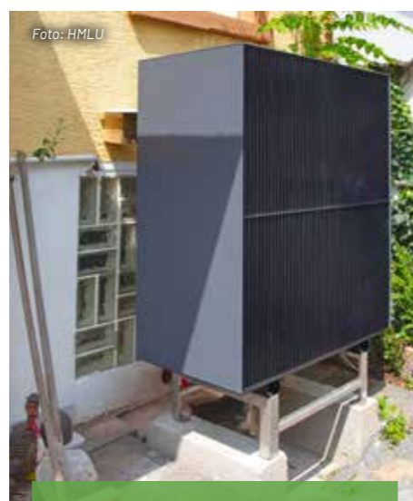
Für eine energetische Sanierung: Die Wärmepumpe.
