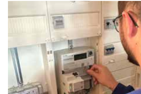
Beim Smart Meter Einbau gilt: Bei Fragen sind die VHM vor Ort der richtige Ansprechpartner.
