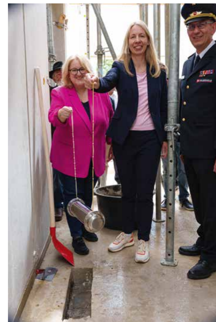
Kreisrätin Marlies Dornieden, Erste Kreisrätin Doreen Fragel und Kreisbrandmeister Karsten Krügener (v.l.) bei der Grundsteinlegung. Foto: Landkreis Göttingen / Jules Stolzenhain
